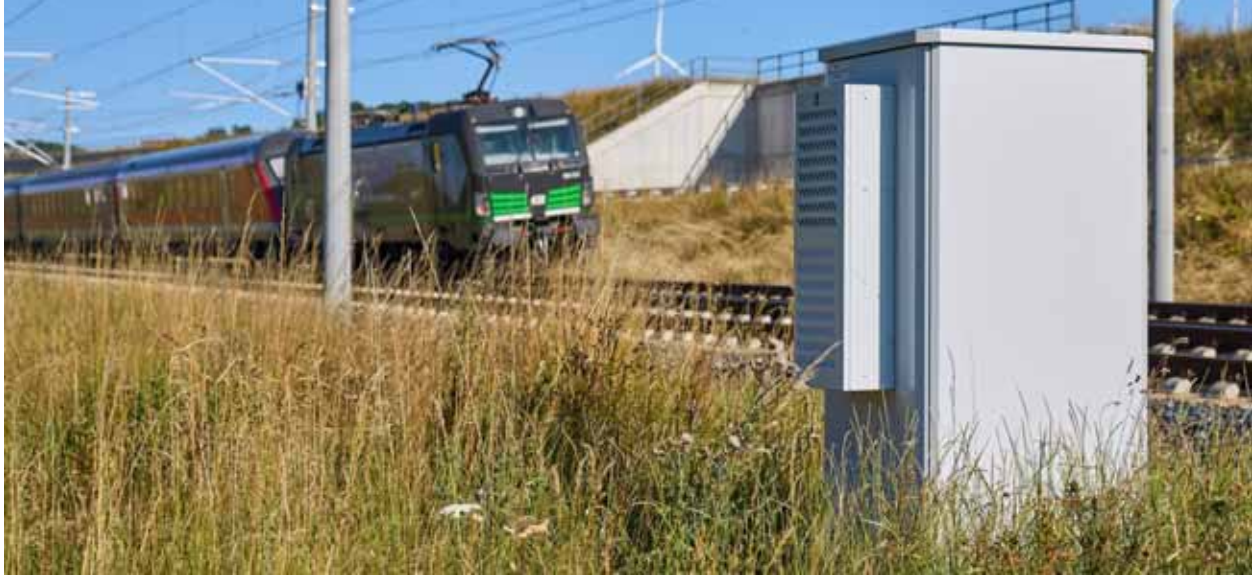
Schaltschränke an der Strecke müssen besonders geschützt sein: vor Witterung, aber auch vor den Kräften vorbeifahrender Züge.
